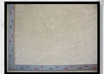
スーパークラックレスを使用したコンクリートの表面状況
