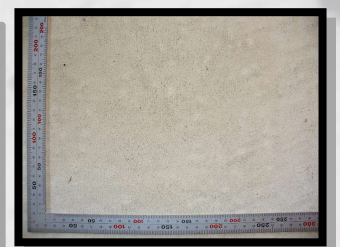
スーパーラックレスを使用したコンクリートの表面状況
